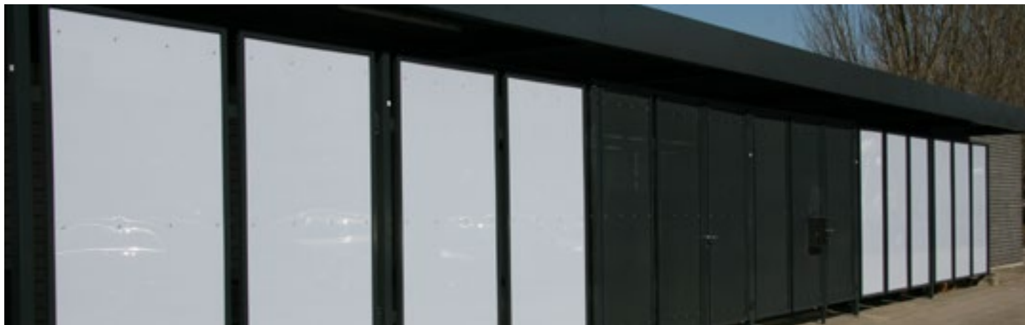
Beklædning med opal polykarbonat og døre med perforeret plade i RAL 7016
